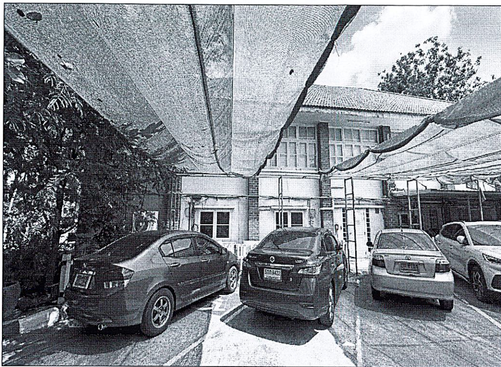
การเดินสายไฟของเดิมด้านหลังอาคารแรก
