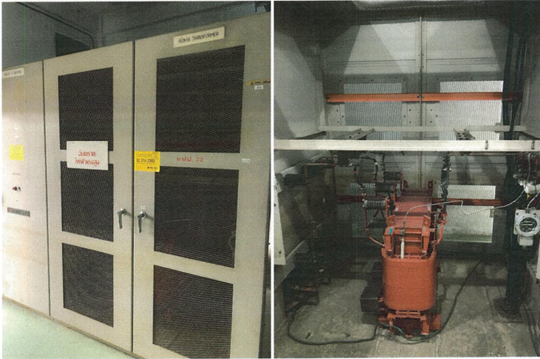
ภาพด้านในอาคาร สถานี LLZ-21R (ตู้ Enclosure ของหม้อแปลงไฟฟ้าแบบแห้งเดิม)
