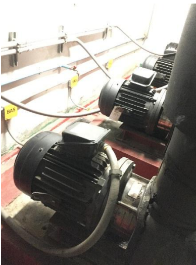
รูปที่ ๕ มอเตอร์ปั๊มน้ำ, ปั๊มน้ำเย็น ของเครื่องปรับอากาศชนิดรวมศูนย์ระบายความร้อนด้วยอากาศ (Air Cool Chiller) Chiller1-3 คัดฟ้าชั้น ๕ ศูนย์ควบคุมจราจรทางอากาศเขตประชิดสนามบินกรุงเทพฯ (ศก.)
