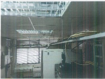
รูปที่ ๖ ทางเข้า RF Cable Low Loss
