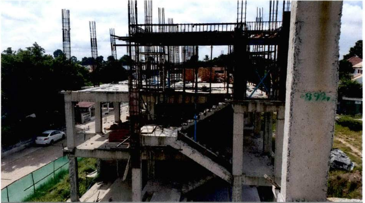
รูปภาพ รื้อแบบหล่อและเหล็กเสริม คาน พื้น เสา ชั้นพื้นที่เก็บน้ำ อาคาร C
