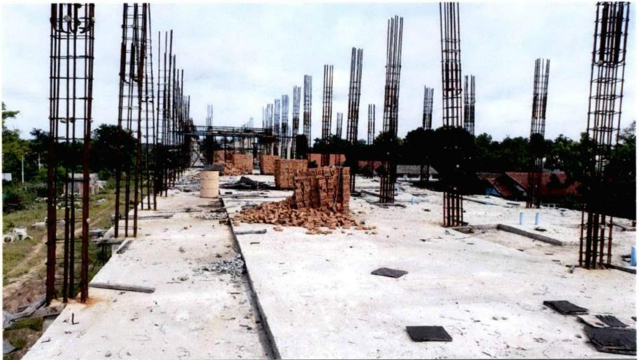
รูปภาพโครงสร้างเสาชั้น 3 อาคาร C ที่ผู้รับต้องดำเนินงานตาม รหัสการแก้ไข A3
