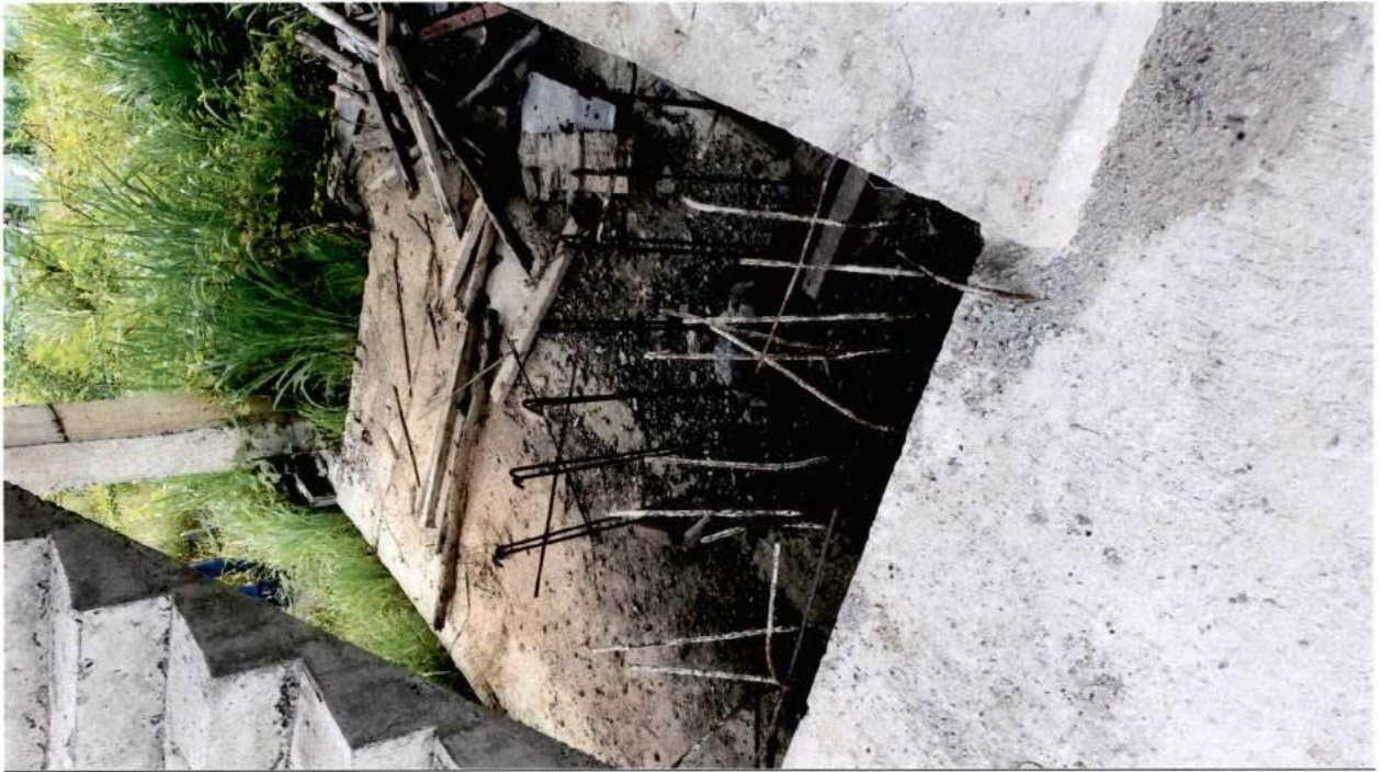
บริเวณ บ้านไต่ทางลง ไต่ชานพักบันได ชั้น 1 ขึ้นชั้น 2 อาคาร C
