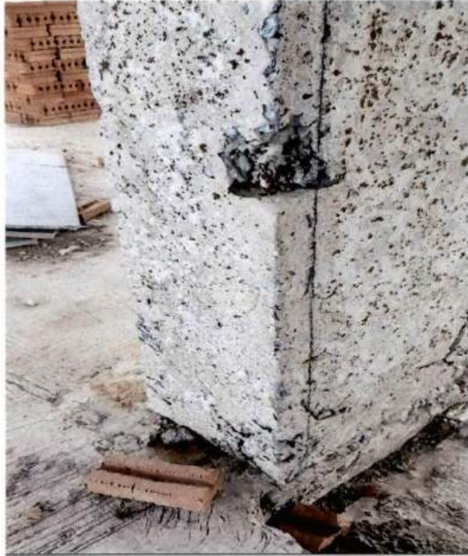
ซ่อมคอนกรีต Line HC-H2 ที่ชั้น 2 อาคาร C โดยใช้ Cement Non Shrink
