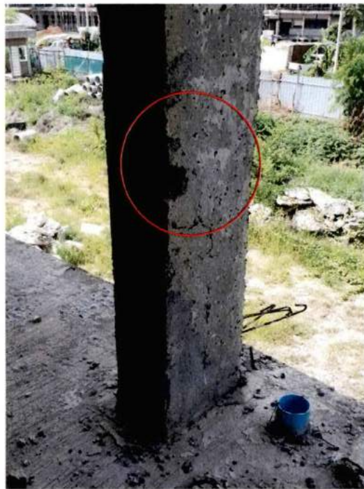
เสาชั้น 2 Line HD-H4 เห็นเหล็กแกนเสา ให้ผู้รับจ้างซ่อมด้วย Cement Non Shrink
