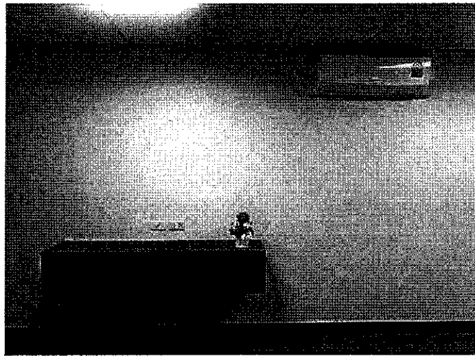
เครื่องปรับอากาศยี่ห้อ Central Air ใหม่ขนาด 12000 BTU
